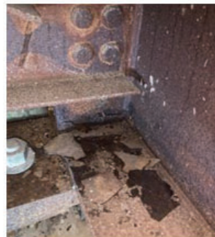
(d) Abutment bridge girder joint: CS 4
