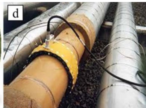
(d) Ultrasonic inspection
