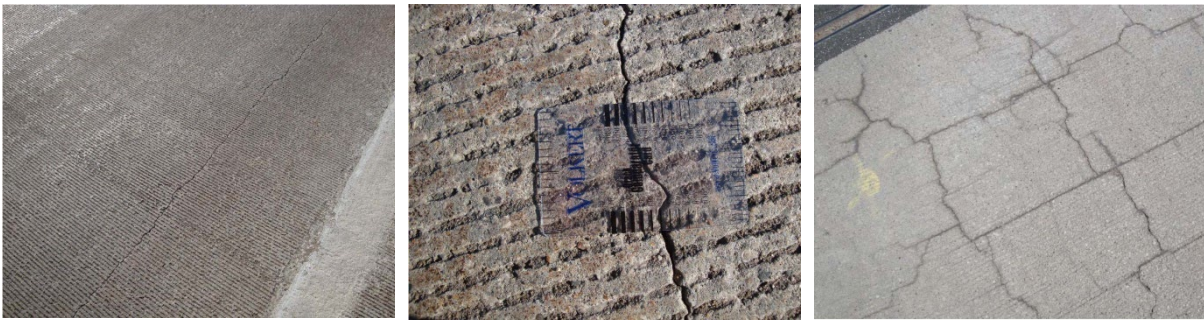
A. Longitudinal cracks
