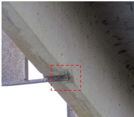
(d) Concrete Spalling at Railing
