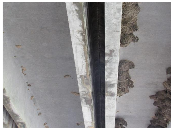
(d) Leakage from joint
