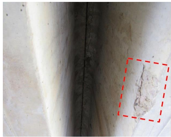
(d) Deterioration at bottom of stem
