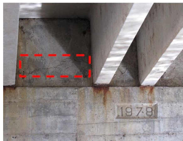
(d) Cracking in diaphragm
