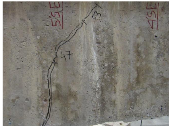
(d) Extension of Crack Width
