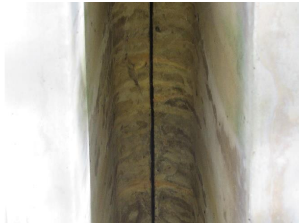
(d) Leakage from joint
