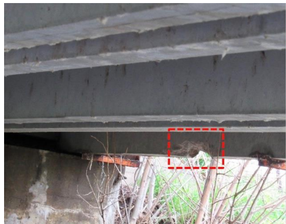
(d) Deterioration at bottom of stem
