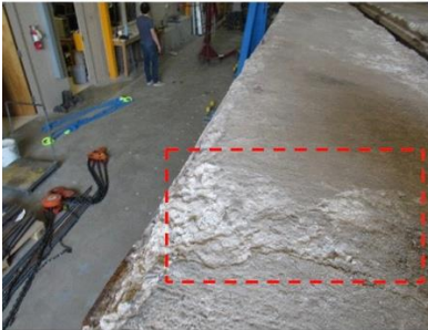
(d) Flange Cover Deterioration (CS-2)
