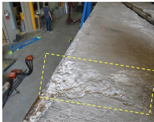
(d) Flange Cover Deterioration
