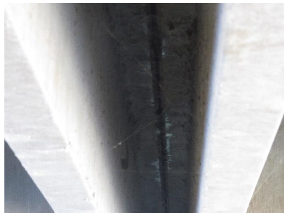
(d) Efflorescence in joint
