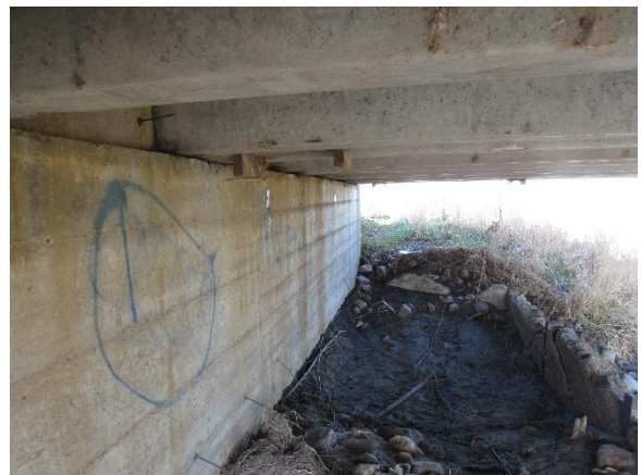
(d) Scouring at abutment of bridge
