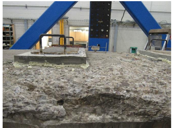
(d) Flange Cover Deterioration
