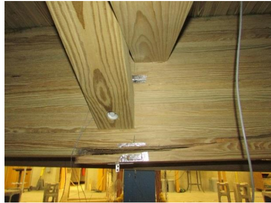
(d) Failure of Interior Girder
