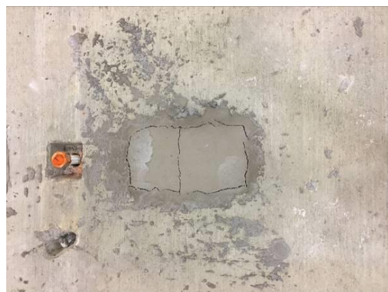
(d) Latex Modified Concrete at 650,000 Cycle
