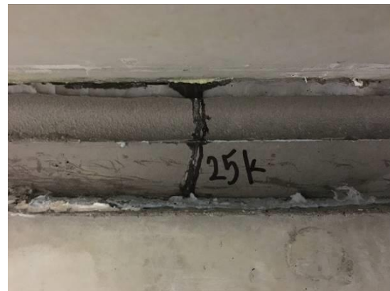
(d) Crack Condition after 650,000 Load Cycle
