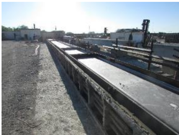
a. Prestressing Bed
