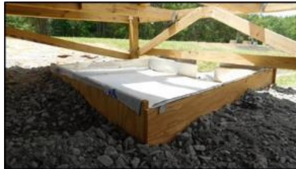
(g) effluent collection platform
