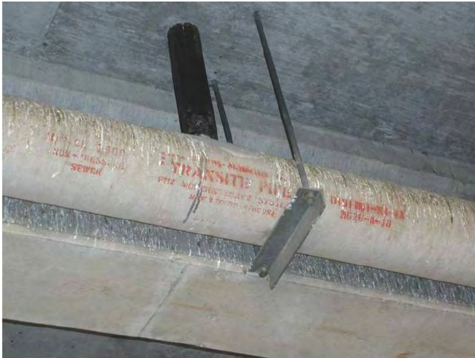
Transite pipe (contains asbestos)
