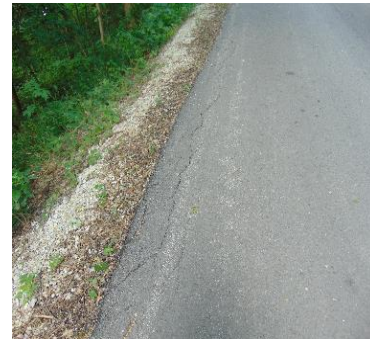
(d) Edge cracks
