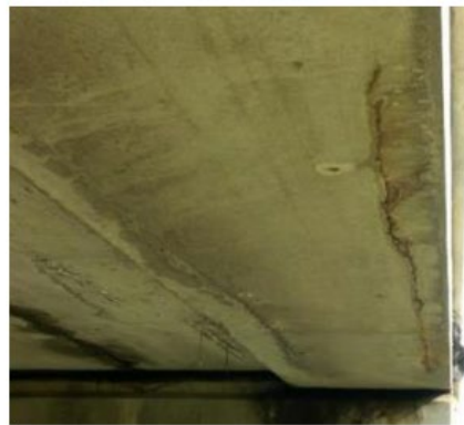
(b) Bottom flange longitudinal cracking
