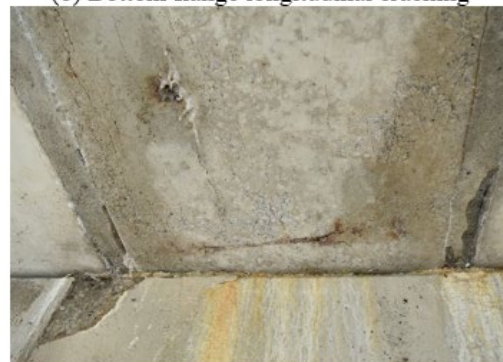
(d) Bottom flange random cracking
