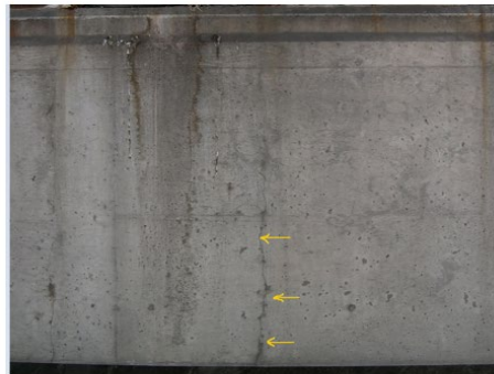
(d) Flexural cracking
