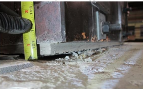
(d) Deformation on tension side
