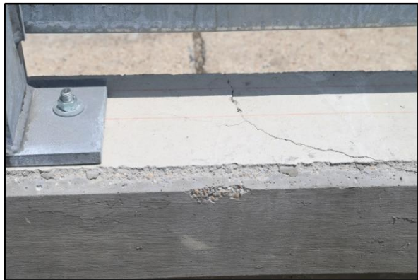
(d) Crack in concrete curb
