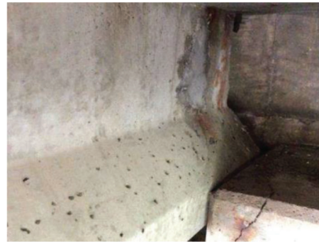
(b) Web Deterioration
