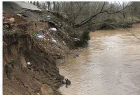
(d) Erosion (Swieteck, 2018)
