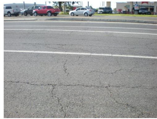
(d) Cracks on the road
