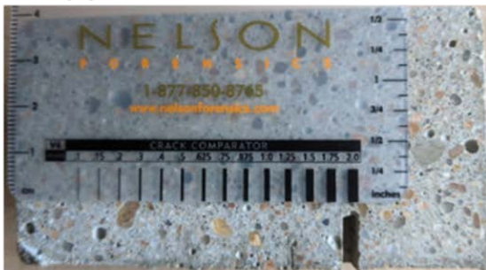
(d) Sectional View of cracks
