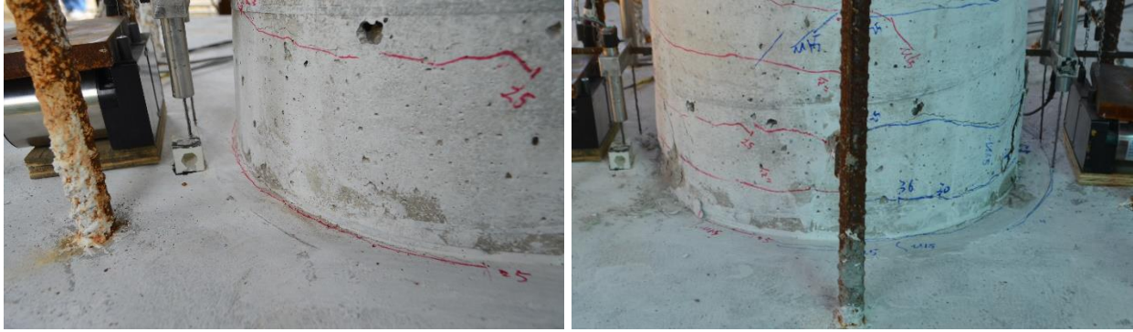
Figure 5.45. Crack at column-to-grout pour interface
