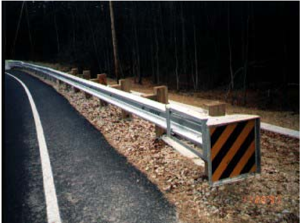
Figure 5.5.14 ET 2000 - Extruder Terminal
