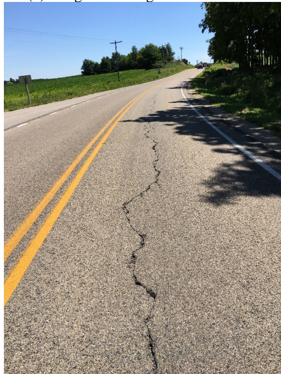
(d) Longitudinal cracking – STH 59
