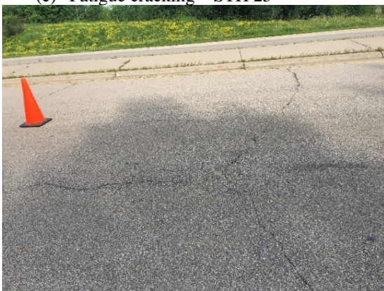
(d) Transverse and Longitudinal cracking – STH 22
