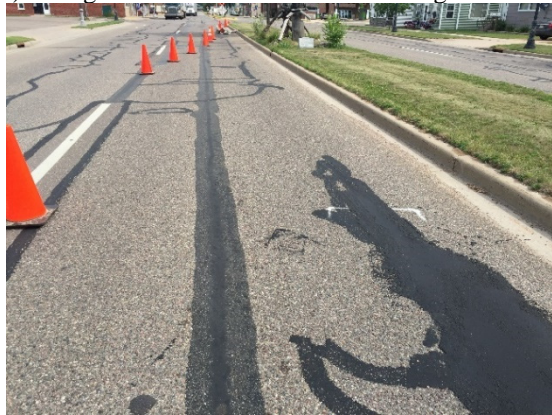
(d) Longitudinal and transverse cracking – STH 86
