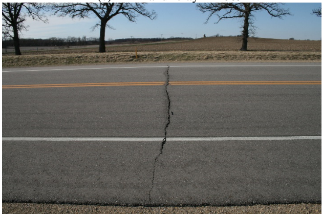
(d) Transversal cracking in 2011 in pavement section II with CA base layer section
