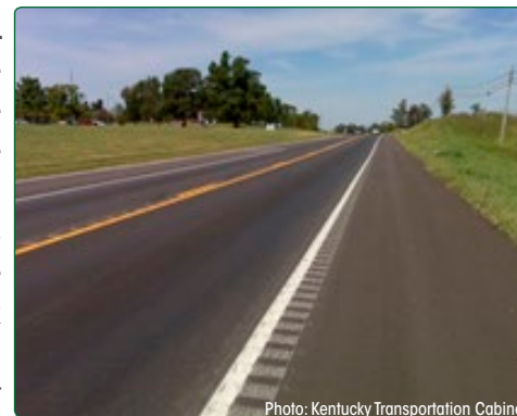
FIGURE 1. Edge Line Rumble Stripes.
