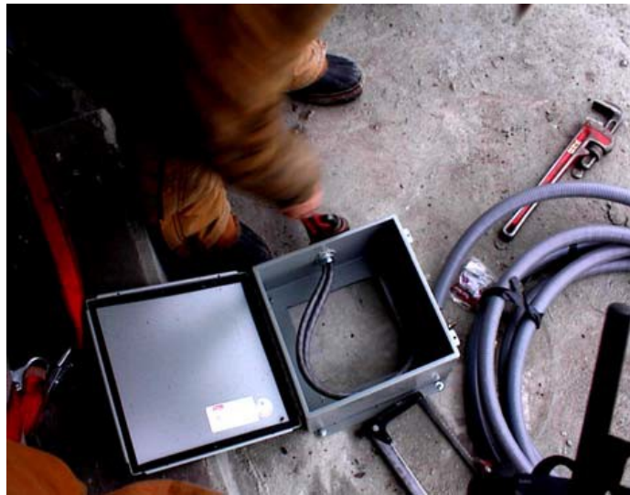
Figure 3.5 NEMA 12 enclosure (UDOT)
