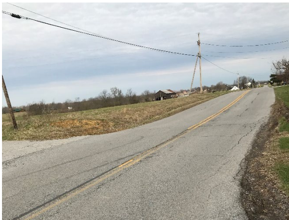
Figure 27. Longitudinal Cracking at Edge
