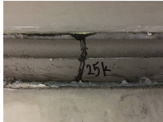
(d) Crack Condition after 650,000 Load Cycle
