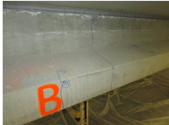
(d) Crack Pattern for Girder B at P = 263 kips
