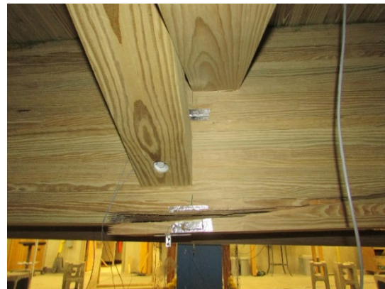
(d) Failure of Interior Girder
