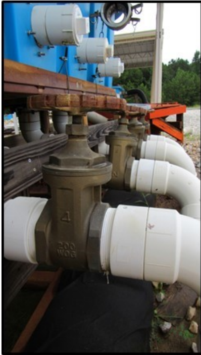
(d) discharge gate valves
