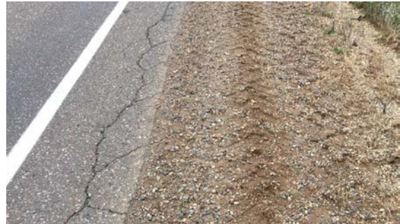
(d) Edge cracking
