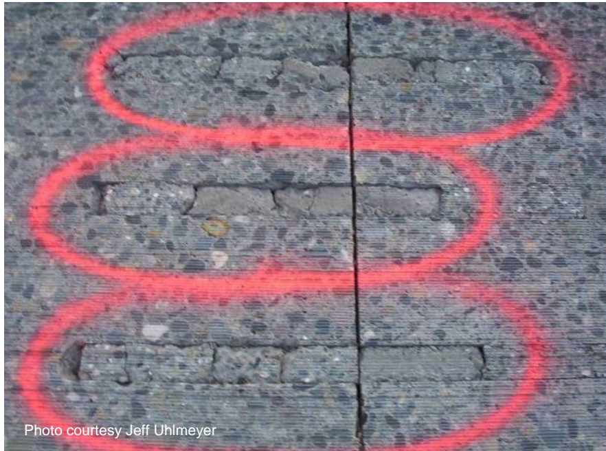
Figure 47 Shrinkage cracks of pour back material.
