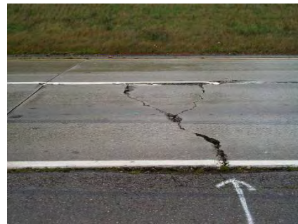
(d) Multiple cracks.
