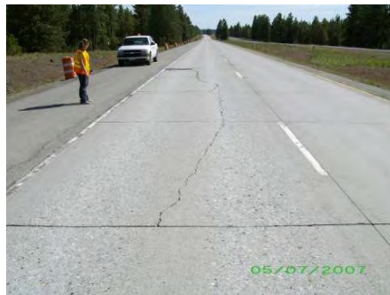
a. Longitudinal cracking
