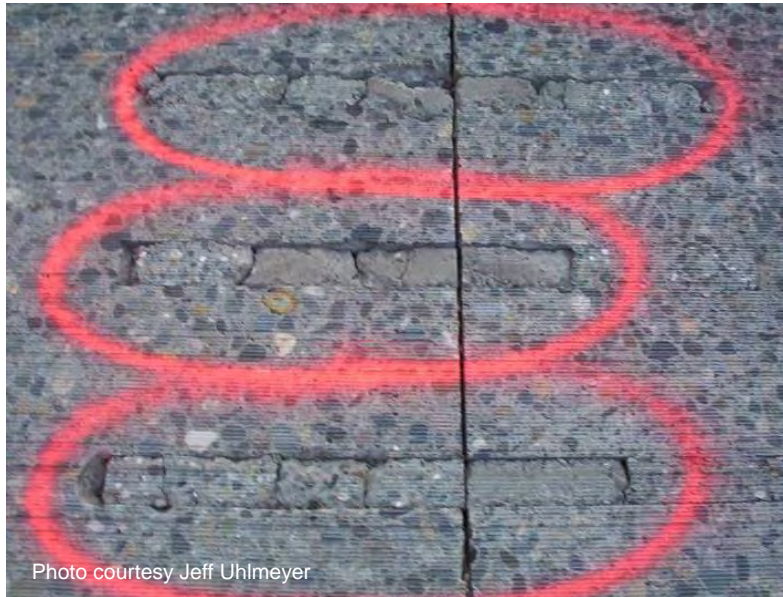
Figure A-48. Shrinkage cracks of pour back material.
