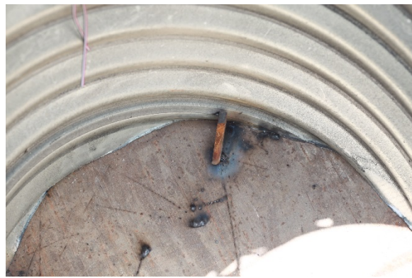
(d) PSV-28B Welded Metal Tabs Securing Corrugated Pipe
