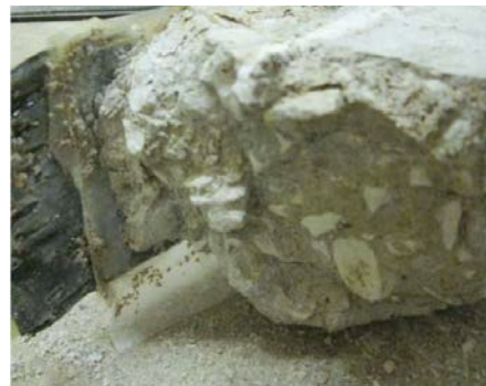
(d) Severe end damage on C-6-A100
