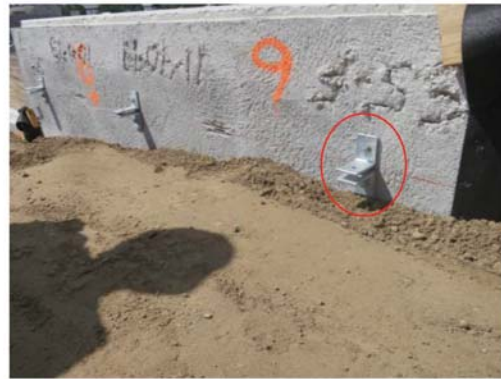
(d) Improper fix of broken connectors
