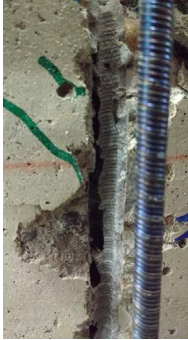
Figure 5.2: Epoxy E2 voids
