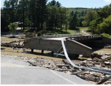
Approach scour (Ludlow, VT).
