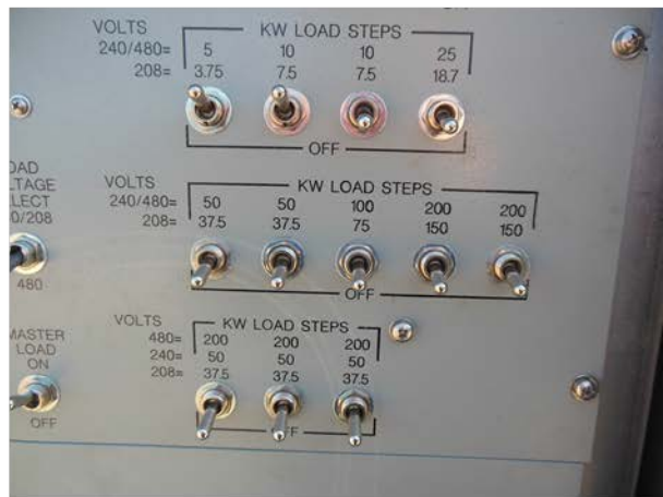
(d) Details of Load Box Load Control Switches
