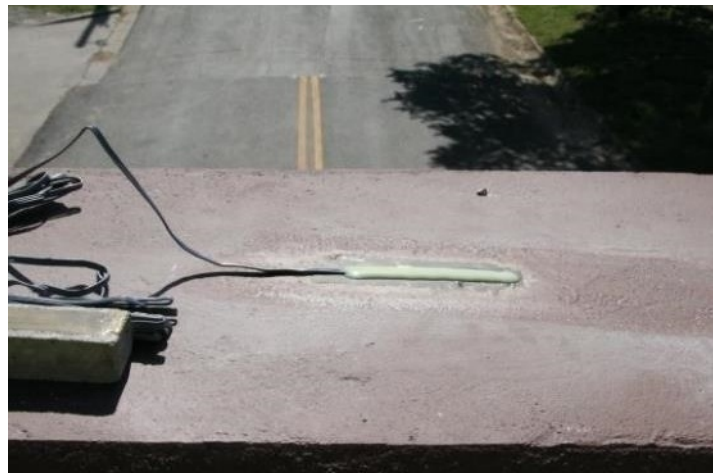
(d) Strain Gage on the Guardrail
