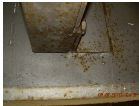
(d) Close-up view of the web gap
