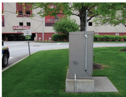
(d) Traffic signal cabinet.
