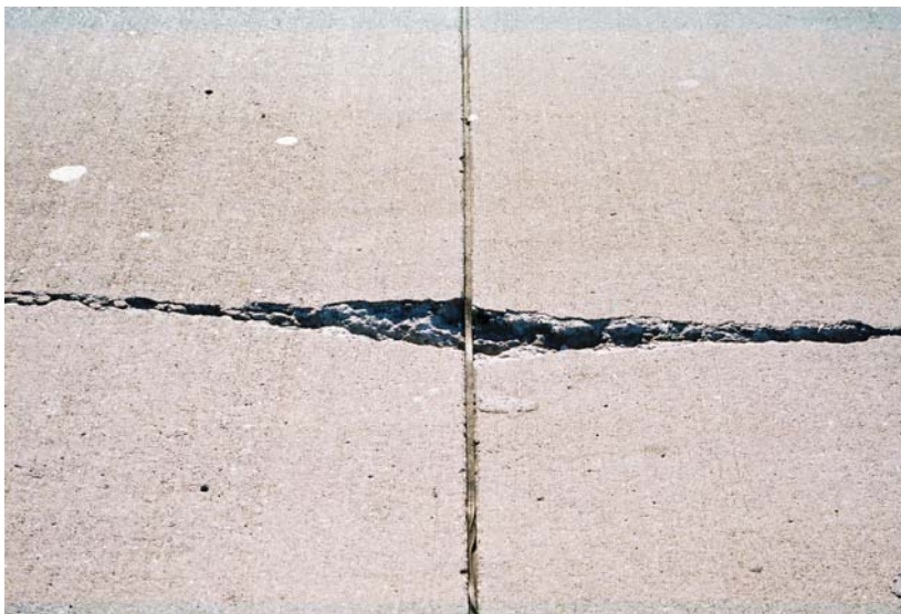
Figure 13a. Longitudinal Crack (Severe)
