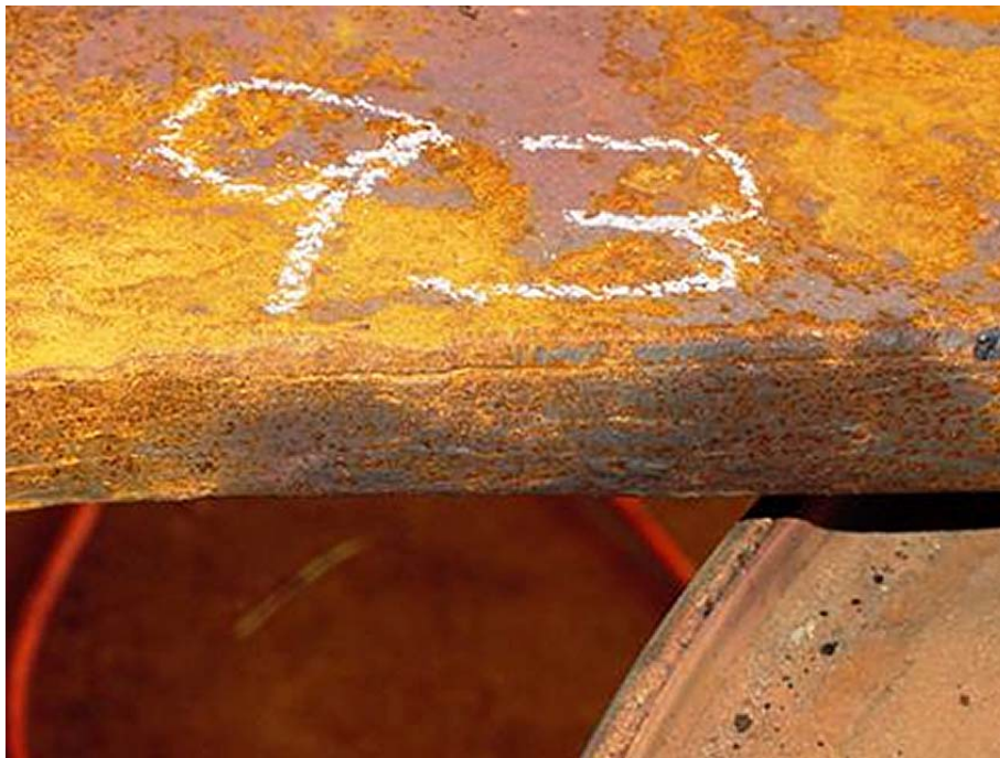
Figure 11. Longitudinal Seam Edge of Bar 93
