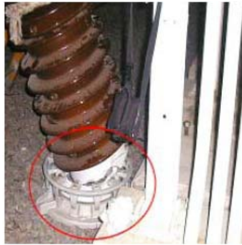
(d) Broken support of interrupter
