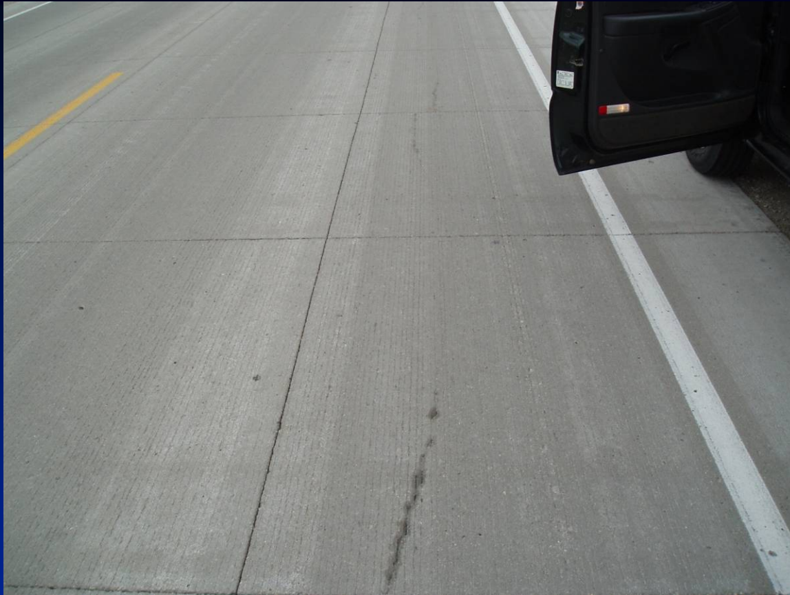
IOWA 175 LONGITUDINAL CRACK
